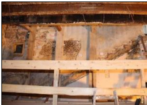
Slika 55. Prvi kat, središnja dvorana, zapadni zid, zatečeno stanje zidnog oslika iz 16. stoljeća prije skidanja sa zida
