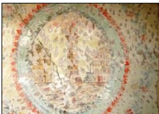
Slika 50. Prvi kat, bočna sjeveroistočna prostorija, zapadni zid, detalj zidnog oslika iz 19. stoljeća
