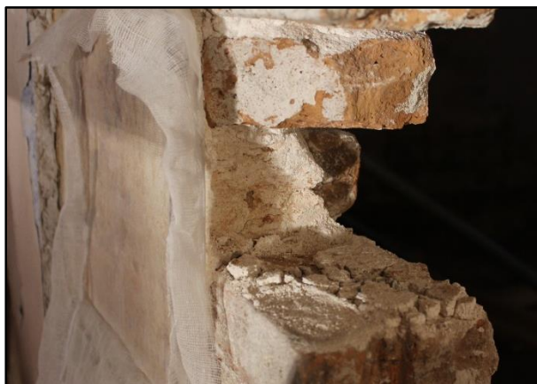
Slika 84. Proba odvajanja opeke s poledine zida
