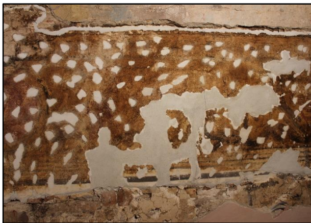
Slika 152. Detalj, prikaz neadekvatnih zapuna iz 2016.
