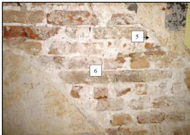
Slika 51. Drugi kat, zapadni zid, sonda otkriva dugačko dijagonalno oštećenje slojeva naliča i žbuke koje upućuju da se ovdje nalazilo jednokrako stepenište između 2. i 3. kata
