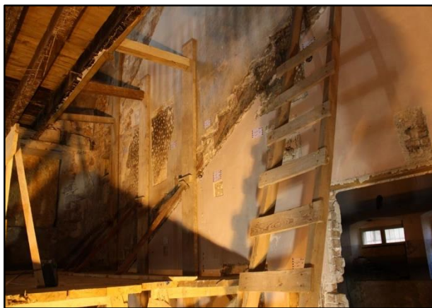
Slika 75. Zatečeno stanje, opečni zid na kojem se nalazio zidni oslik
