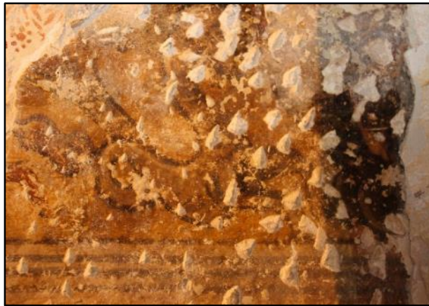
Slika 80. Detalj, pukotine i ogrebotine
