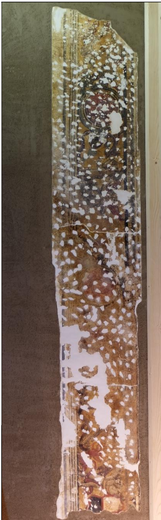
Slika 193. Cjeloviti fragment nakon nanošenja dvaju slojeva žbuke NHL Maschinenputz na zid te pokretni nosač sve do rubova fragmenta.
