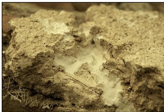
Slika 26. Manje pukotine u žbuci poleđine zapunjene su smjesom materijala VAPO 0/1 i vode.
