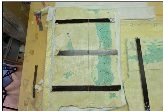
Slika 147. Gotovo u potpunosti uklonjena panel ploča. Nije uklonjena samo na mjestima gdje je vijcima pričvršćena za vertikalne drvene letvice.
