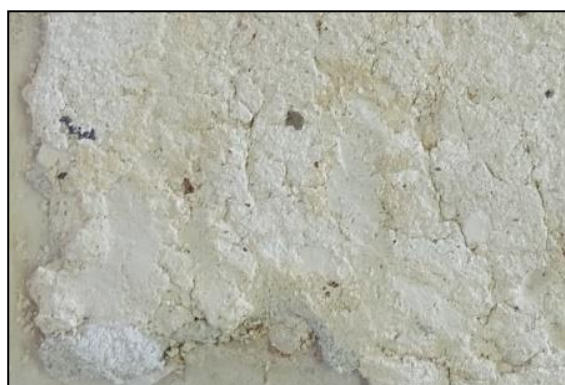
Slika 138. Oštećenja poledine žbuke intonaca ispunjena nadoknadnom žbukom.
