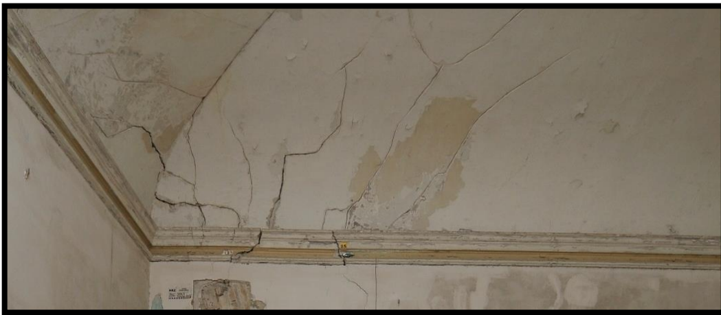
Slika 55 Prostorija 208, svodne pukotine nastale uslijed slabljenja nosivosti svodne konstrukcije
