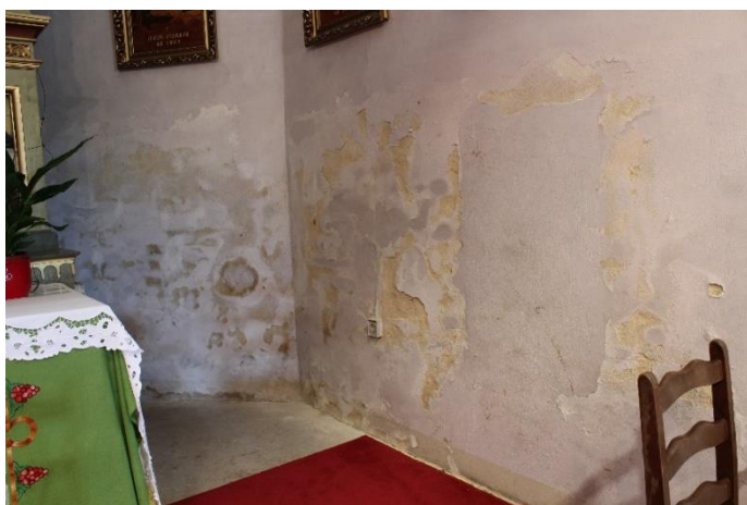
Sl. 85 - Vlaga na zidovima svetišta
