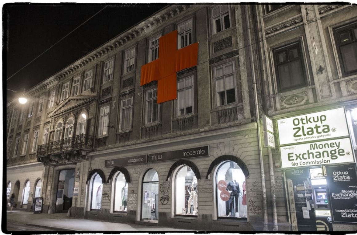
slika 26. Crveni križevi na oštećenim zgradama u potresu, Ilica 44, Zagreb, 2020. (foto Jasmin Krpan)
