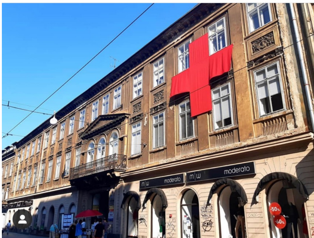
slika 41. Crveni križevi na oštećenim zgradama u potresu, Beli Zagreb grad, Zagreb, 3.9.2020.
