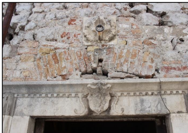
Slika 43. Zapadno pročelje, portal prvog kata, prikaz otučenoga grba
