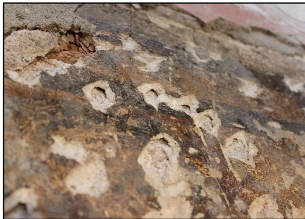
Slika 78. Detalj, podbuhline i odvojeni dijelovi žbuke
