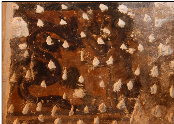
Slika 79. Detalj, natučanja u sloju intonaca
