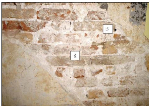
Slika 51. Drugi kat, zapadni zid, sonda otkriva dugačko dijagonalno oštećenje slojeva naliča i žbuke koje upućuju da se ovdje nalazilo jednokrako stepenište između 2. i 3. kata
