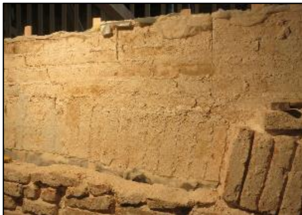
Slika 65. Detalj, plitki rasteretni luk unutar strukture zida
