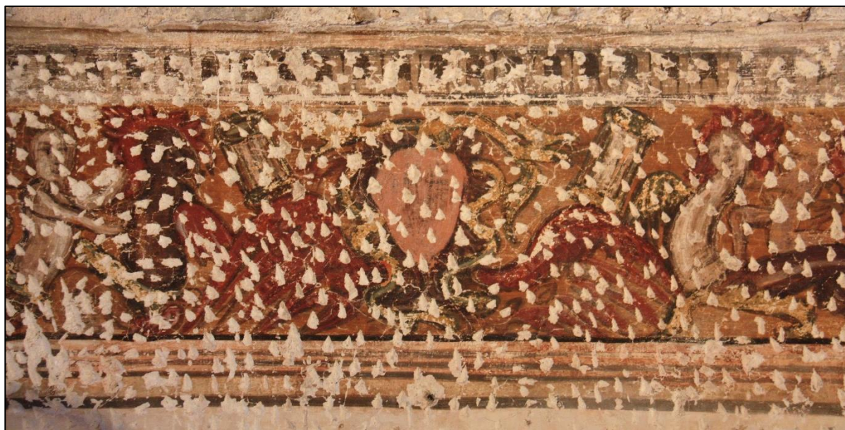
Slika 71. Dio oslika vijenca na sjevernom dijelu zapadnog zida u središnjem salonu prvog kata kuće Moise.
