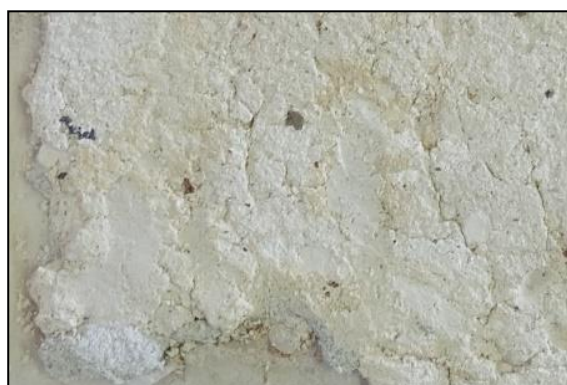
Slika 138. Oštećenja poledine žbuke intonaca ispunjena nadoknadnom žbukom.
