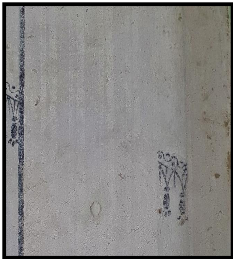
Slika 62 Drugi kat, prostorija 208, sjeverni zid, slabo vidljivi tragovi kanelira
