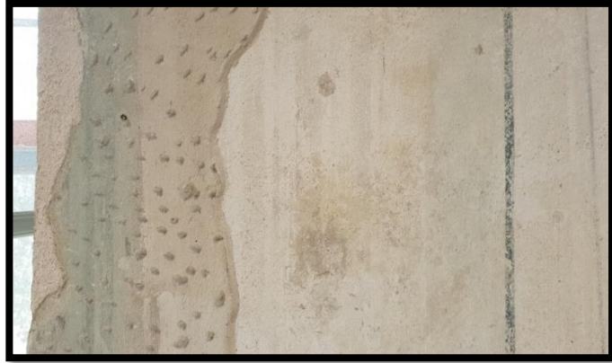
Slika 56 Prostorija 208, sjeverni zid, otučenja u prvom slikanom sloju
