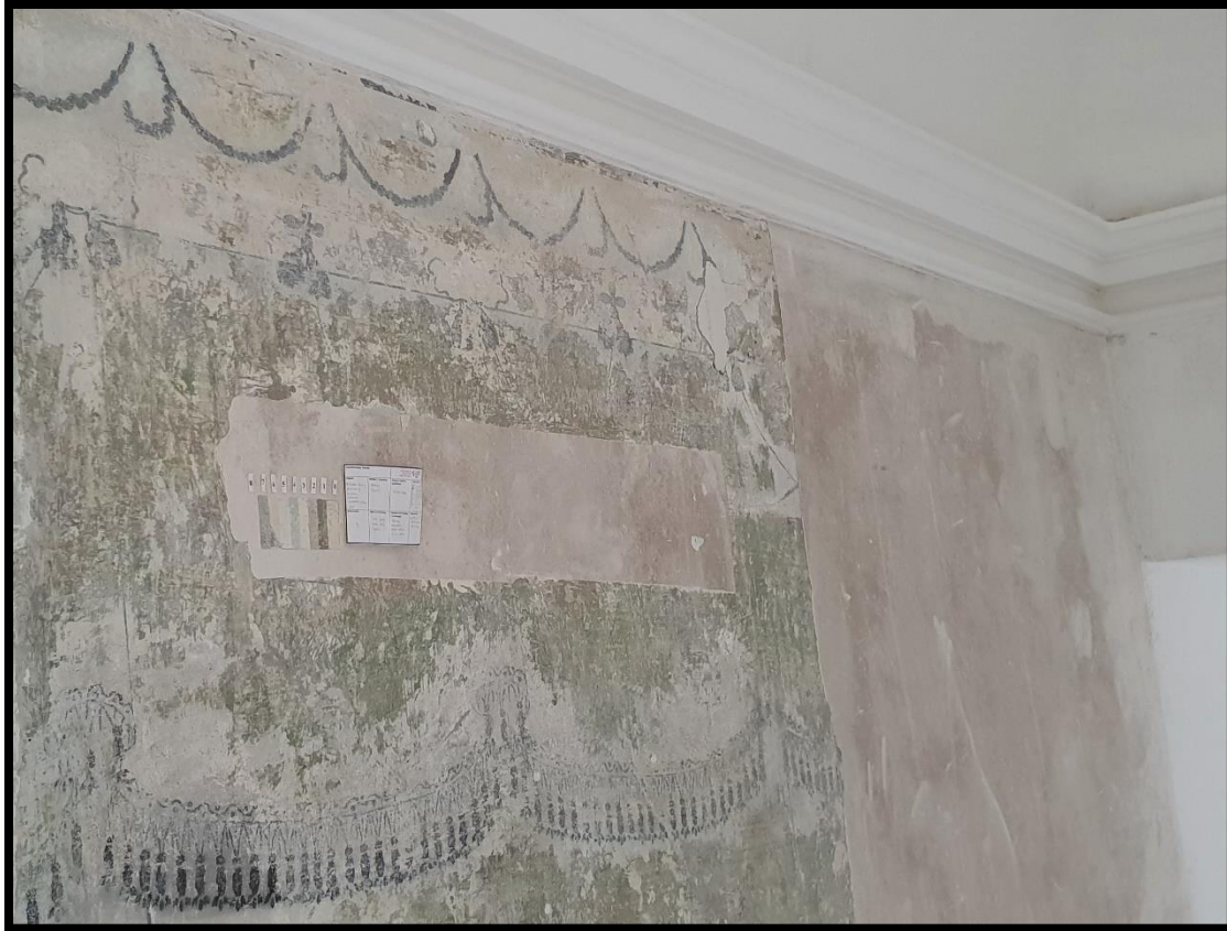
Slika 39 Prostorija 208, istočni zid, otkrivajuća sonda u gornjem dijelu zidnog oslika
