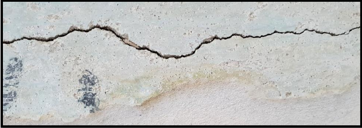
Slika 60 Drugi kat, prostorija 208, sjeverni zid, oštećenja ispod profilacije nastala od uvođenja elektrifikacije
