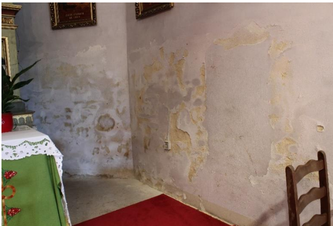
Sl. 85 - Vlaga na zidovima svetišta
