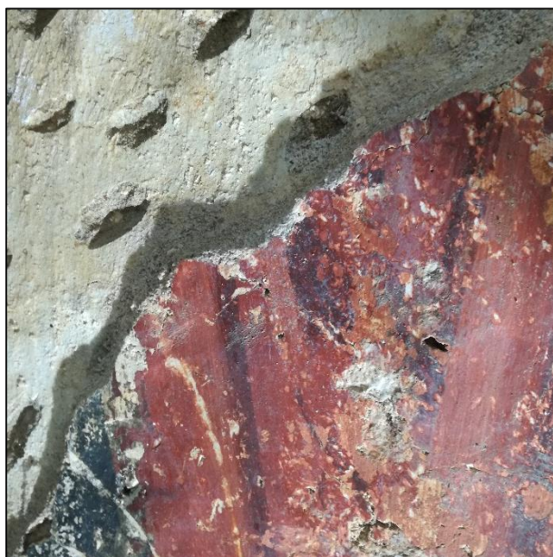
Slika 93. Detalj zidne slike na otvoru arkade, vidljiva natučenja
