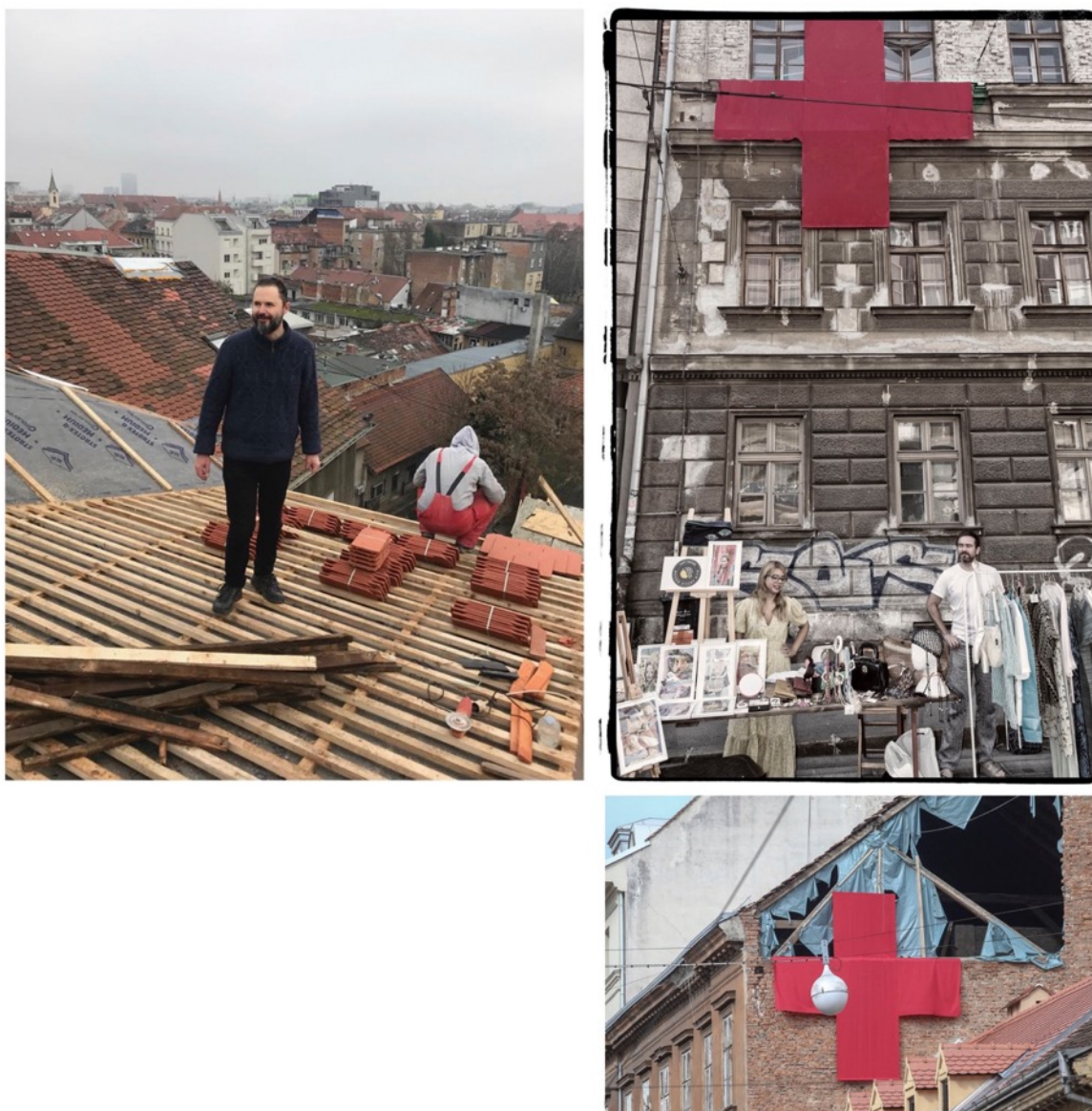
slika 34. Crveni križevi na oštećenim zgradama u potresu , u sklopu Projekt Ilica: Q'art i akcije na sanacijama zgrada i krovšta nakon potresa, Zagreb, 2020.
