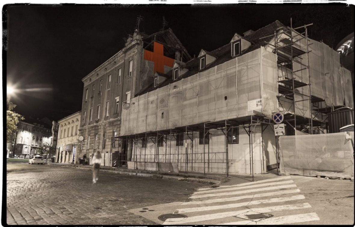
slika 28. Crveni križevi na oštećenim zgradama u potresu, Britanski trg 12, Zagreb, 2020. (foto Jasmin Krpan)
