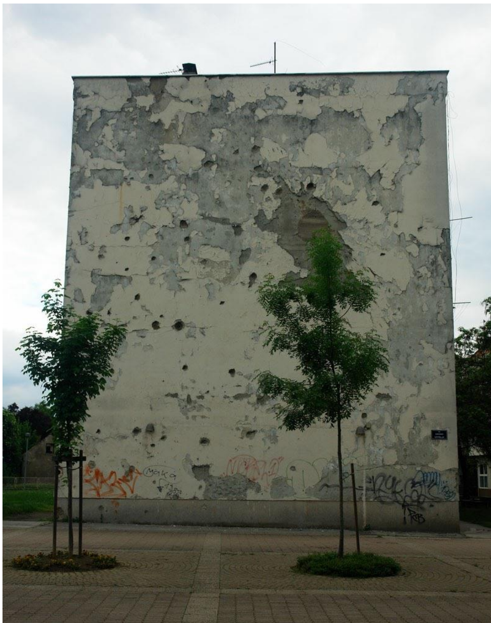
Slika 34 Zgrada u centru grada s izrazito vidljivim ranama rata (foto: Davor Žilić)
