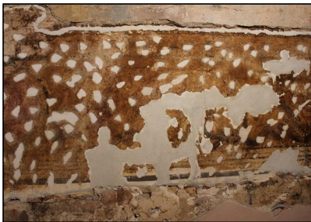
Slika 152. Detalj, prikaz neadekvatnih zapuna iz 2016.
