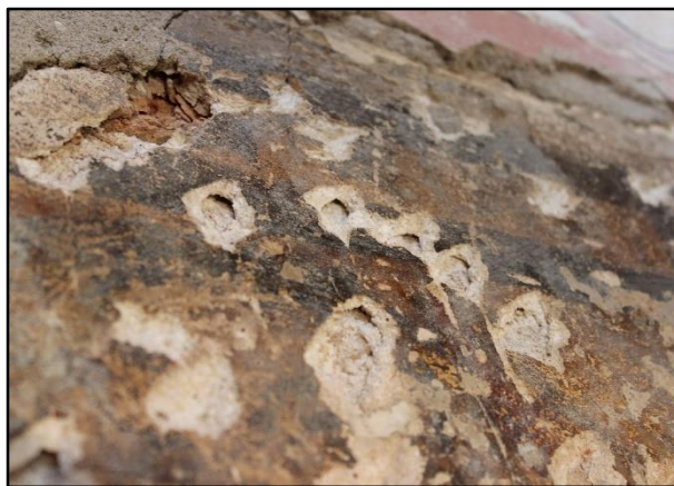
Slika 78. Detalj, podbuhline i odvojeni dijelovi žbuke
