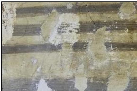
Slika 187. Testno područje u donjem desnom uglu fragmenta. Žbukane nadoknade tonirane su lazurnim nanosom lokalnog tona.
