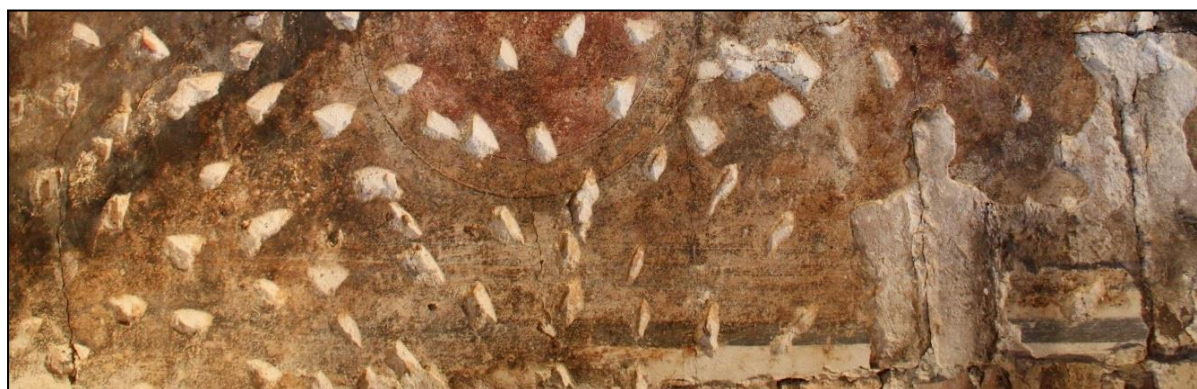
Slika 114. Površina slikanog sloja istrošena je i istanjena gotovo do nečitljivosti. Intonaco i slikani sloj ispucali su u središnjoj zoni oslika, na mjestu lučno građenog opečnog nosača (okomite pukotine nalaze se na mjestu sljubnica).
