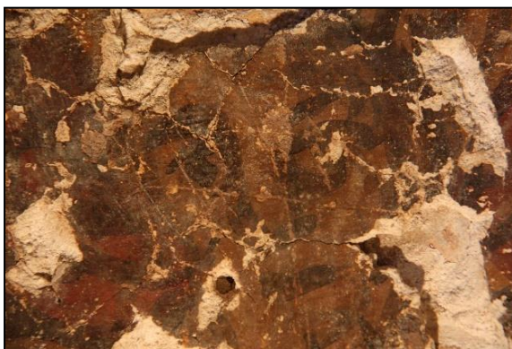
Slika 111. Mreže pukotina koje presijecaju slikani sloj i intonaco .
