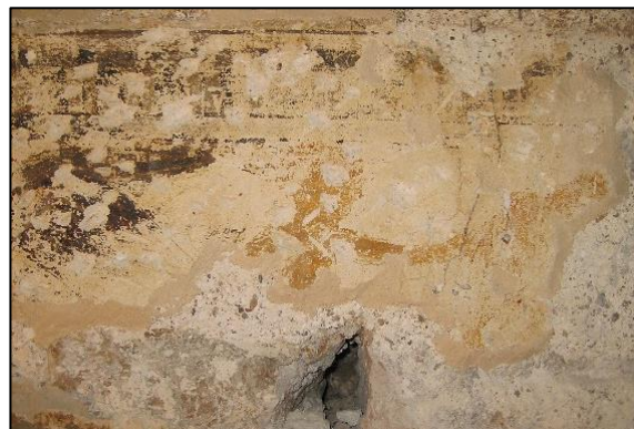
Slika 82. Detalj „opšava“ od nadoknadne žbuke, nanosenih oko očuvanih fragmenata zidnog oslika vijenca na jugoistočnom zidu središnjeg salona.
