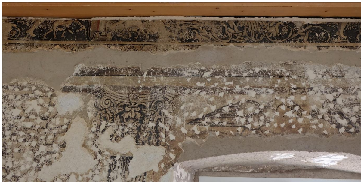
Slika 81. Dio zidnog oslika iz 16. stoljeća na sjevernom dijelu zapadnog zida, na trećem katu kuće Moise. U gornjoj zoni fotografije vidljivi su motivi flore i faune na ostacima friza. U središnjem dijelu fotografije vidljiv je bogato ukrašen slikani kapitel. Desno od njega naziru se suprotstavljeni likovi, ptica i reptil.
