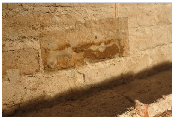
Slika 126. Gubitak slikanog sloja i žbuke na središnjem dijelu fragmenta zidne slike. Oštećenja nastala prilikom odvajanja opečnih blokova od žbuke privremeno su učvršćena japanskim papirom i akrilnom smolom Paraloid B72 .
