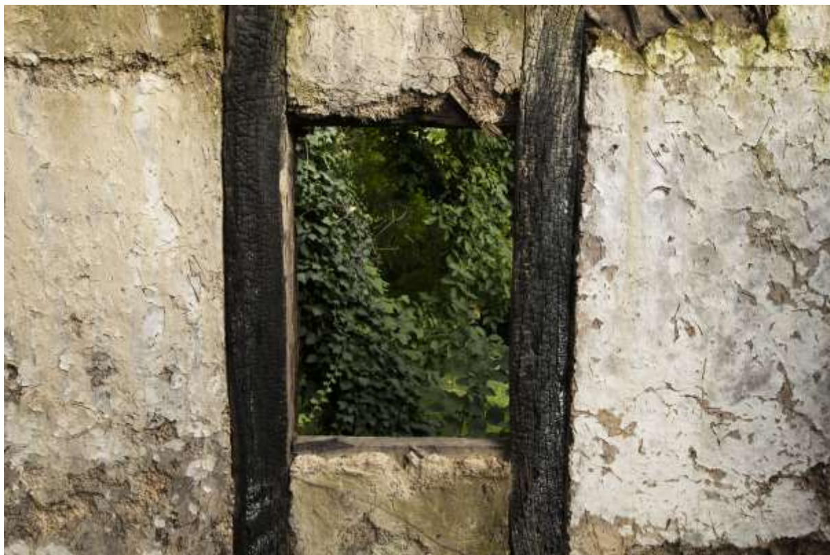
Slika 36., slika 37., slika 38., Fotografija seoske kuće stradale u požaru, fotografirao; Petar Koši
