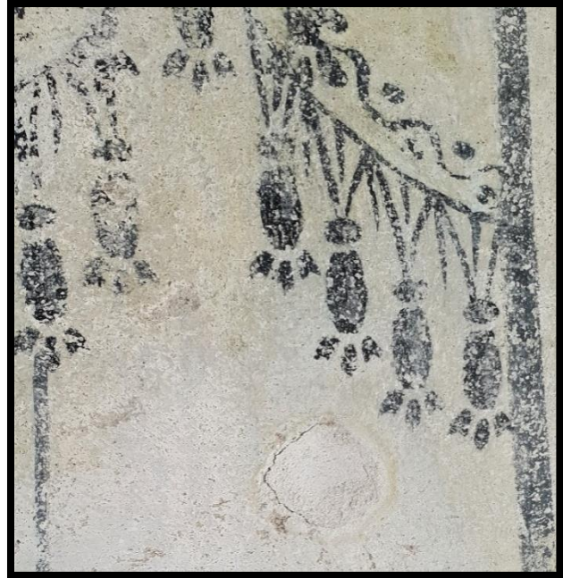
Slika 58 Drugi kat, prostorija 208, sjeverni zid, neadekvatni zakit
