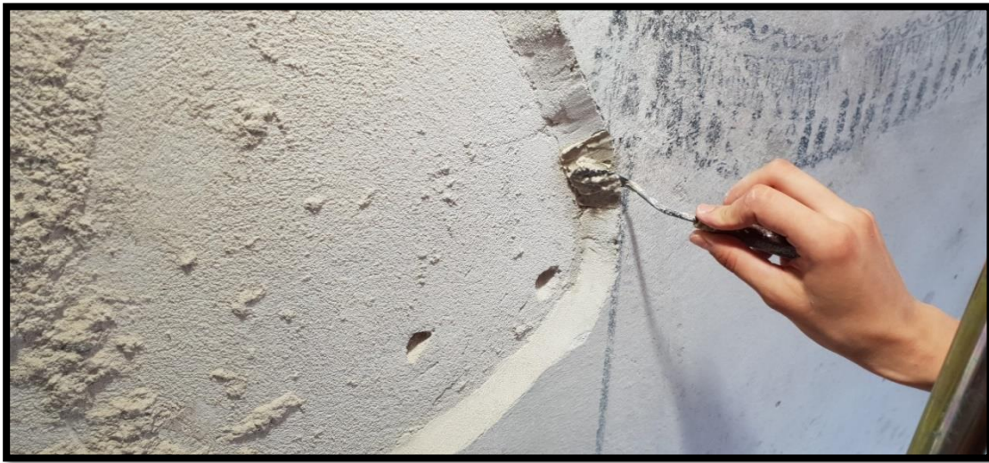
Slika 79 Prostorija 208, sjeverni zid, obrublјivanje oštećenja
