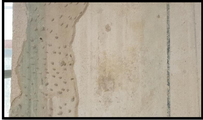
Slika 56 Prostorija 208, sjeverni zid, otučenja u prvom slikanom sloju
