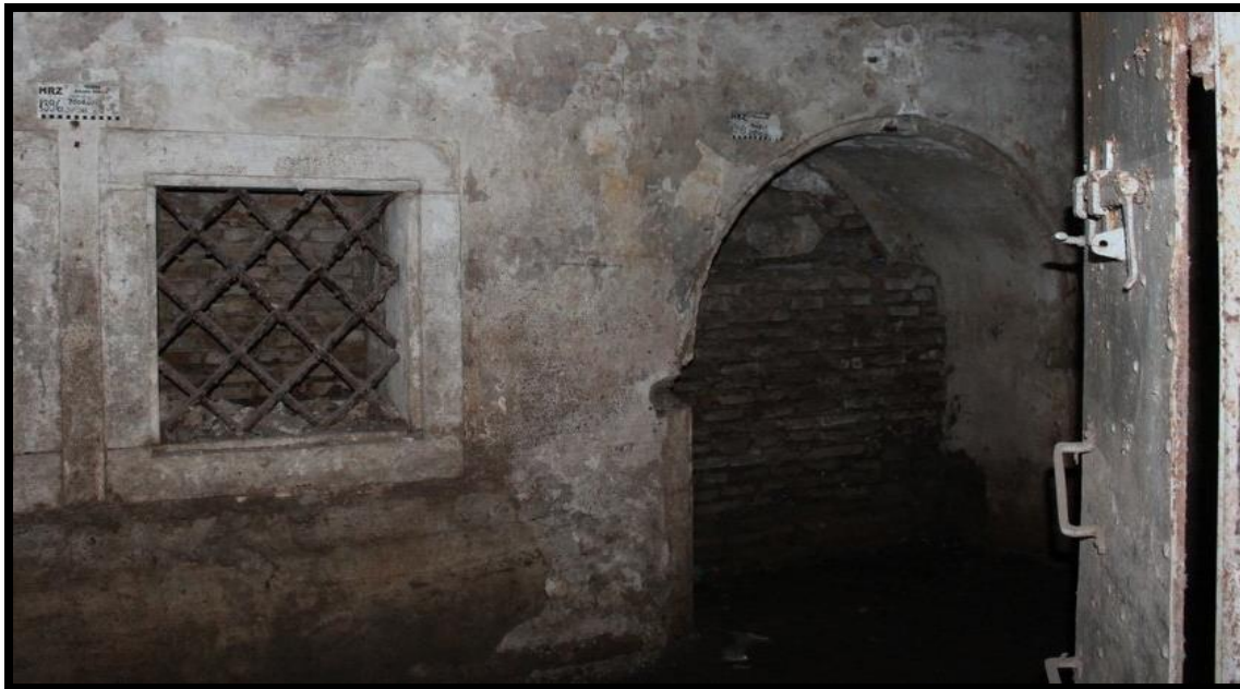
Slika 54 Podrum palače, dotrajale rešetke i oštećeni zidovi zbog posljedica prekomjerne vlage
