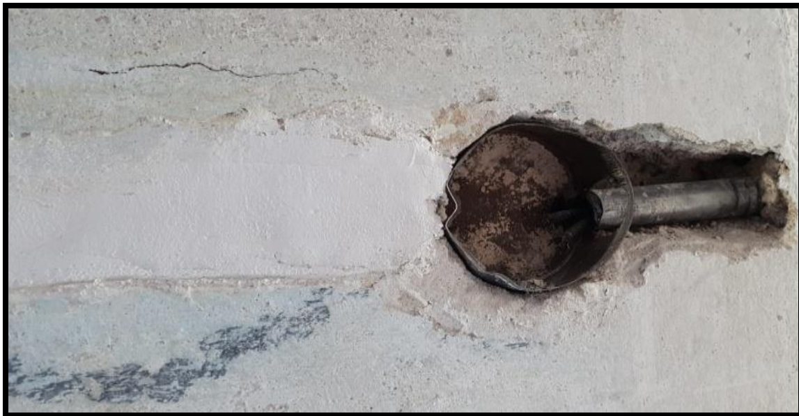
Slika 59 Drugi kat, prostorija 208, sjeverni zid, oštećenje od naknadne elektrifikacije
