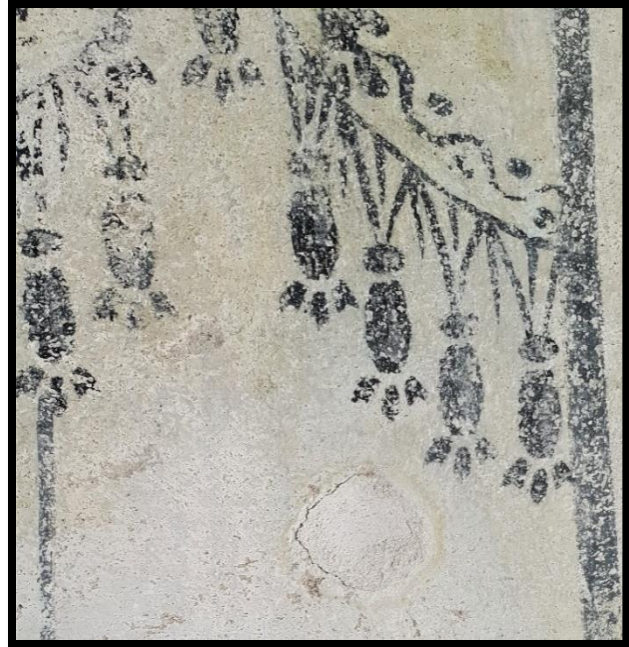
Slika 58 Drugi kat, prostorija 208, sjeverni zid, neadekvatni zakit
