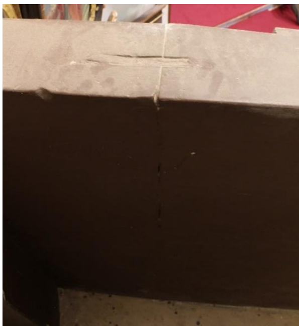
Sl. 41 - Metalna spojnica na gornjoj strani ograde, pogled s propovjedaonice
