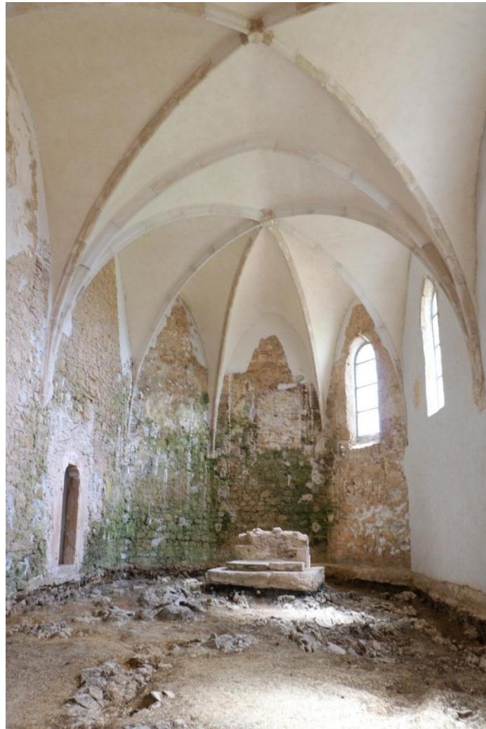
Slika 6: Pogled na svetište s rekonstruiranim gotičkim svodom s rebrima, stanje iz 2018. godine
