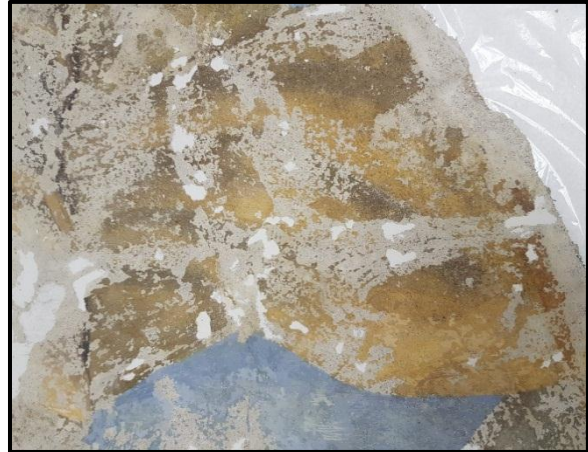
Slika 72. Detalj površine sa nadoknadama žbuke
