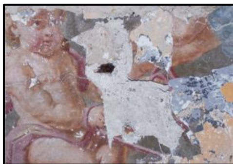
Slika 99. Detalj zidne slike gdje se vidi slaba povezanost između slojeva
