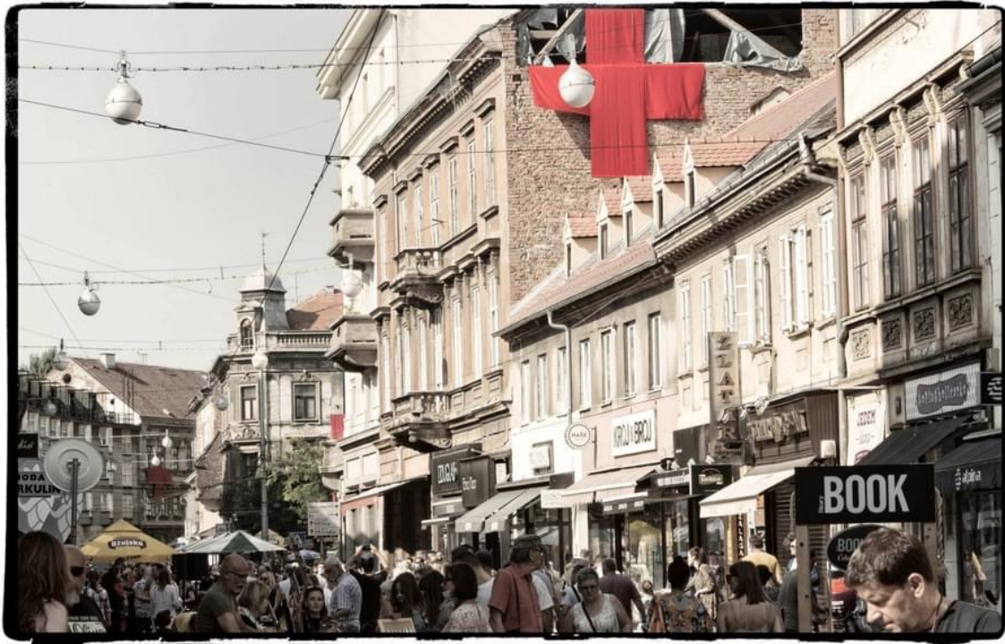
slika 32. Crveni križevi na oštećenim zgradama u potresu , u sklopu Projekta Ilica: Q'art, Zagreb, 2020.
